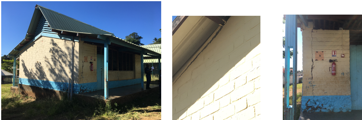
Fig. 12 : Collège de Bandré (type case SIM) avec fissure à la jonction des murs et décalage de la charpente en bois / murs. Dégâts degré 2 pour une classe de vulnérabilité A. (photos-AS-BCSF).
