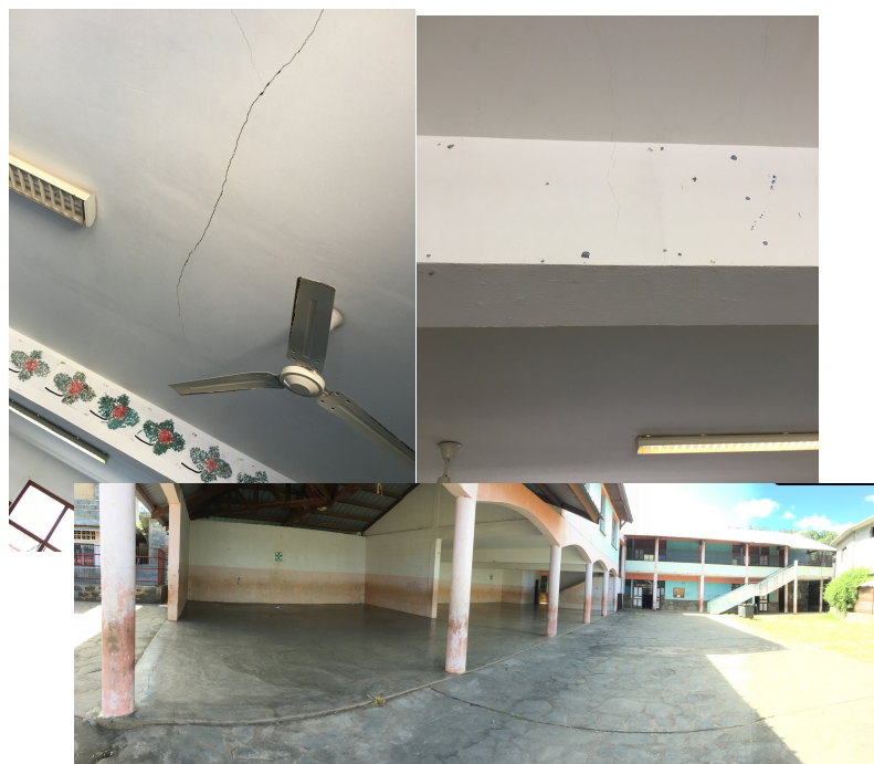
Fig. 37 – Ecole maternelle Centre, dommages de degré 2 (fissuration fine, murs, plafonds et poutres). (Photo CS/BCSF)
