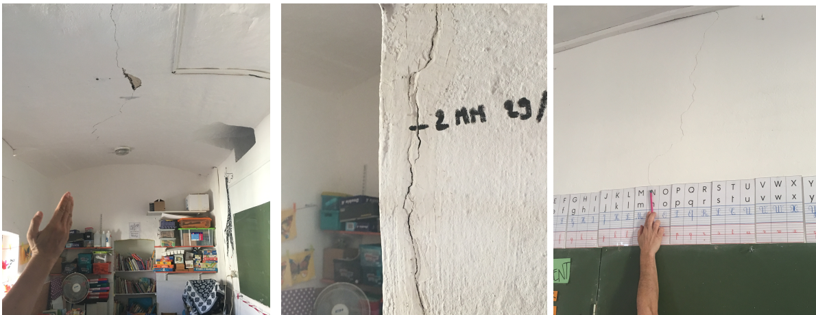
Fig. 26 : Ecole élémentaire « Les Colibris » en maçonnerie: Gauche : voûte avec affaissement central. Centre: exemple d'une fissure de 2mm observée le 29 mai. Droite. Exemple de fissure fine dans un mur. Dégâts degré 2 pour une vulnérabilité B. (photos-AS-BCSF).
