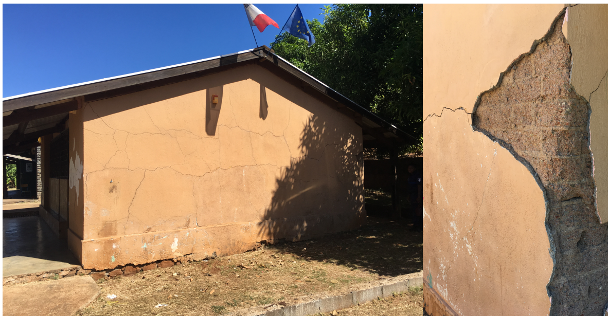
Fig. 28 : Poste de Police, en maçonnerie friable avec épais enduit très fortement fissuré et des parties détachées. La prolongation des fissures dans les murs n'est pas visible. Dégâts de degré 1 à 2 et classe de vulnérabilité A. (photos-AS-BCSF).
