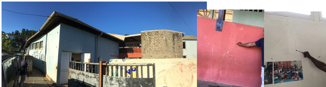
Fig. 19 – Ecole maternelle du centre, vulnérabilité C, endommagement de degré 1 (photo-CS-BCSF).
