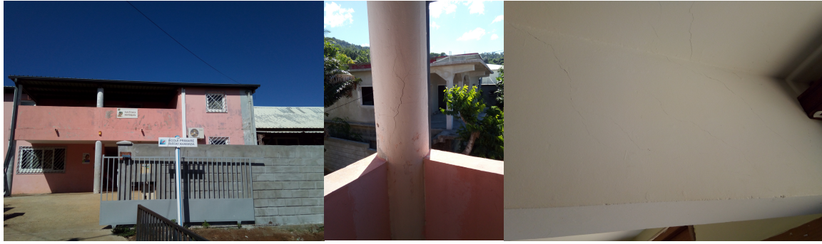
Fig. 16 : Ecole primaire Riffay Ahamada, vulnérabilité B, endommagement de degré 2 (fissures dans de nombreux murs, poteaux et poutres porteuses) (photo-ER-OPGC).
