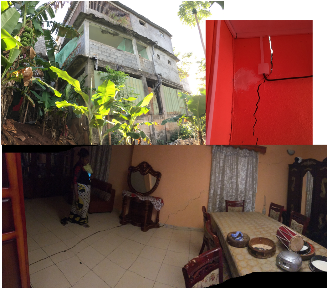
Fig. 47 – Maison en ossature béton armé et parpaings, RC+2 sur terrain en pente, préalablement endommagée, dommages de degré 3 (vulnérabilité A). La partie arrière vers la pente se détache du reste du bâtiment. La partie avant (RC sur la rue) est extrêmement fissurée (fissuration larges murs, planchers, ossature). (Photo CS/BCSF)
