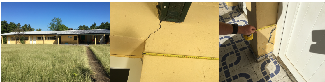
Fig. 15 : – école maternelle Rossignol à Bambo ouest, vulnérabilité B, endommagement de degré 2 (fissures dans de nombreux murs et sur des poutres porteuses (photo-CS-BCSF).
