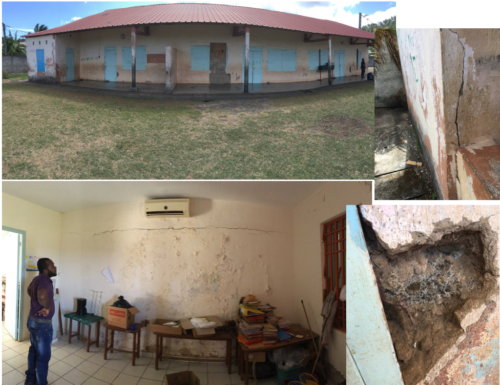
Fig. 38 – Ecole primaire n°1, vulnérabilité A, maçonnerie de pierres (endommagement préalable), dommages de degré 2 (fissuration, murs, plafonds). (Photo CS/BCSF)
