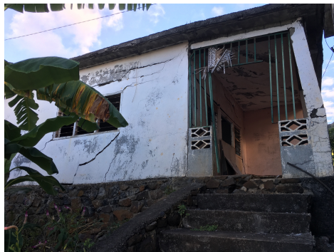
Fig. 35 – Quartier Fouboudi, dommages de degré 3 préalable aux séismes, construction de vulnérabilité B – (Photo CS/BCSF).
