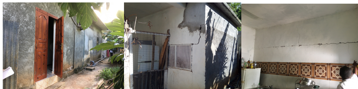
Fig. 20 – Quartier Poroani, Maison ossature béton et maçonnerie de parpaings, dommage de degré 2 (photos-CS/BCSF& ER/OPGC).
