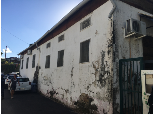
Fig. 25 : Ecole élémentaire « Les Colibris » Vu extérieure montrant l'enduit vétuste avec nombreuses fissures mais dont leur extension dans les murs reste spéculative. (photo-AS-BCSF).
