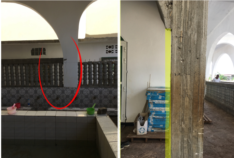
Fig. 7 : Fissuration fine probablement sur du remplissage de colonne.
