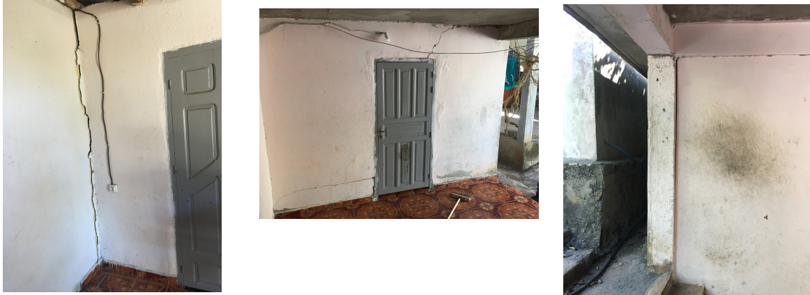
Fig. 14 : Maison ossature béton armée et remplissage en maçonnerie, avec de nombreuses fissures dans la maçonnerie, à la jonction maçonnerie/ossature et dans les liaisons poteaux-poutres. Dégâts de degré 2 pour une vulnérabilité B. (photos-AS-BCSF).
