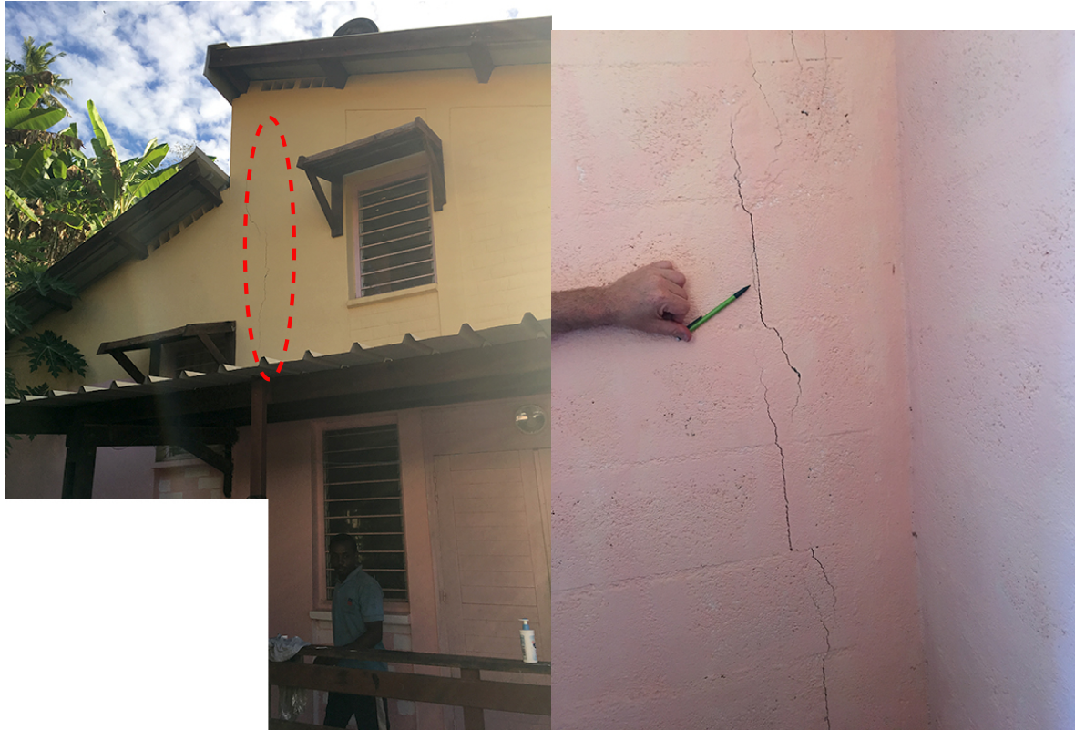
Fig. 9 : Fissure traversante sur maison en maçonnerie et poteau poutre (degré 2 sur vulnérabilité estimée B) (photos-AS-BCSF).
