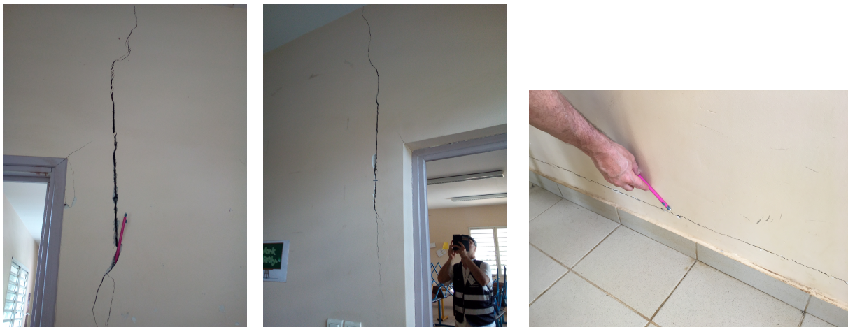
Fig. 22 – Collège de Dembeni. Gauche et centre : Fissure ouverte centimétrique. (photos-MB-OPGC). Droite : Base du mur fissuré et bombé vers l'extérieur en relation avec la fissure (photos gauche et centre) sur mur perpendiculaire. (photo-AS-BCSF).
