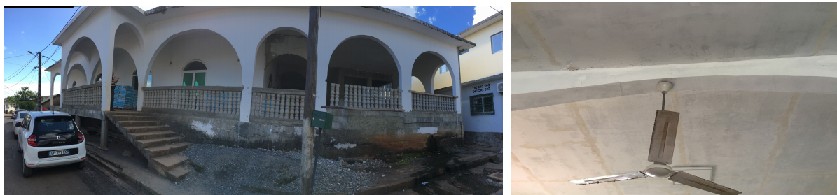
Fig. 6 : Grande mosquée du vendredi ossature béton et maçonnerie de parpaings. Fissure fine sur voûte en béton.
