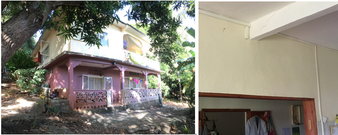
Fig. 8 : Fissuration d'une poutre porteuse d'une maison individuelle en dur (vulnérabilité C).
