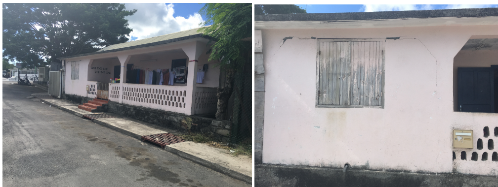
Fig. 41 : secteur ouest de Pamandzi, en bord de mer, ossature béton armée et remplissage en maçonnerie majoritairement construites avec du sable de mer favorisant la corrosion des aciers. Fissures aux liaisons ossature et remplissage. Les dégâts sont principalement de degré 1 à 2 pour une vulnérabilité A. (photos-AS-BCSF).
