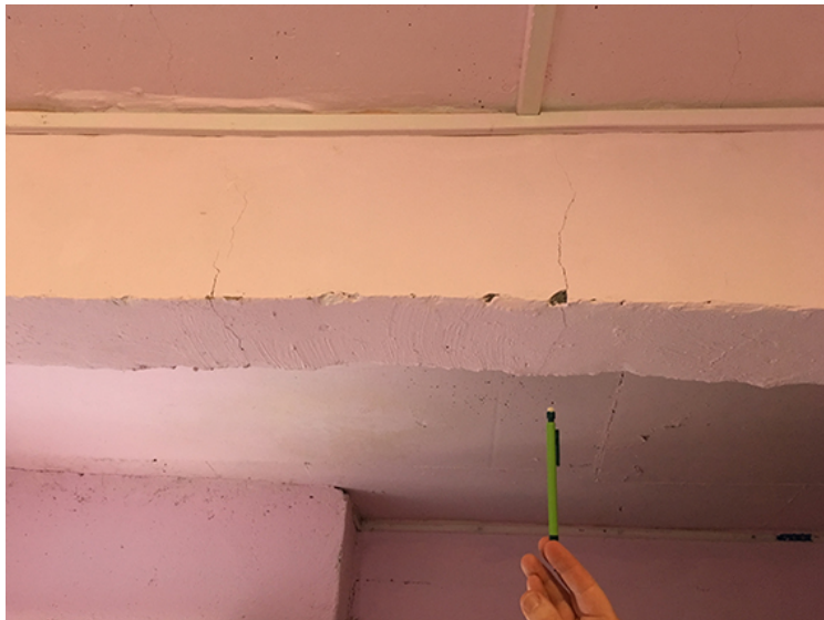
Fig. 10 : Plusieurs fissures fines traversantes sur une poutre d'une maison en zone de mangrove (degré 2 sur ossature béton armé et remplissage en maçonnerie, vulnérabilité estimée B) (photo-AS-BCSF).
