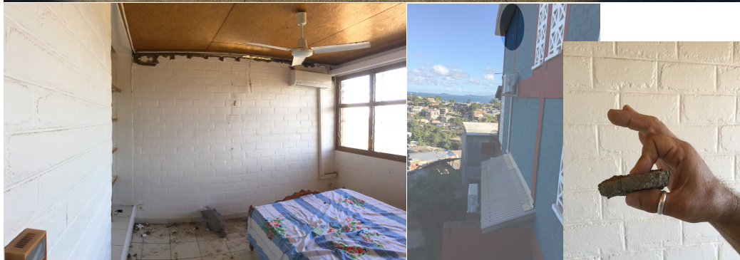
Fig.32 – Immeuble SIM, ossature béton et briques d'argile, dommages de degré 2 (photos-CS/BCSF).
