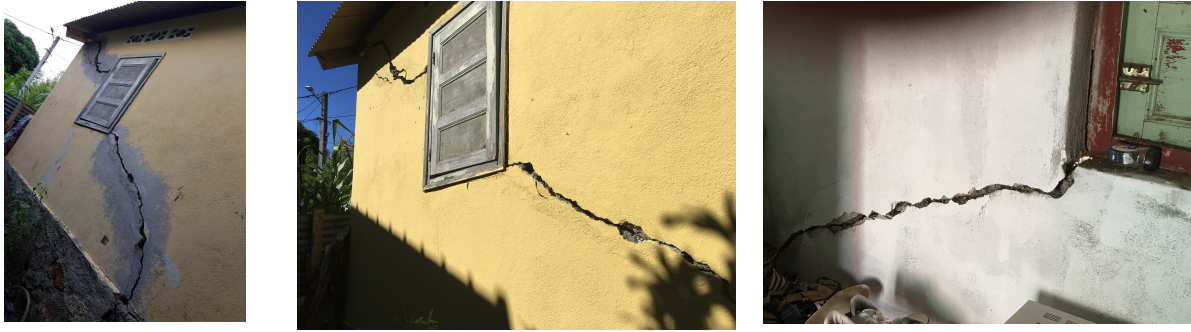
Fig. 11 : Maison avec dégâts de degré 3, réouverture d'anciennes fissures. Photo de gauche : Effets constatés par les services la commune de Bandré. Photo centrale : Photo du 12-06 (après peinture). Photo droite. Vue de l'intérieur. (photos-AS-BCSF).
